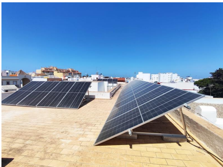
Placas fotovoltaicas en cubierta
